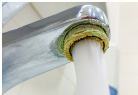
Verkalkte Armaturen und Duschköpfe fördern das Bakterienwachstum.
