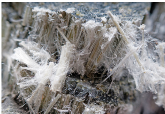
Wird Asbestzement über die Jahre brüchig oder wird es bearbeitet, werden die schädlichen Fasern freigesetzt.
